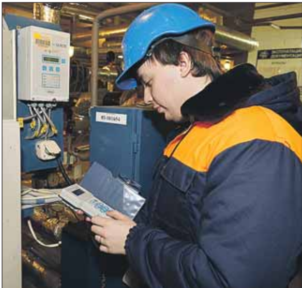
Специалист предприятия №1 филиала №3 ОАО «МОЭК» проверяет работу оборудования в ЦТП Бутырского района
